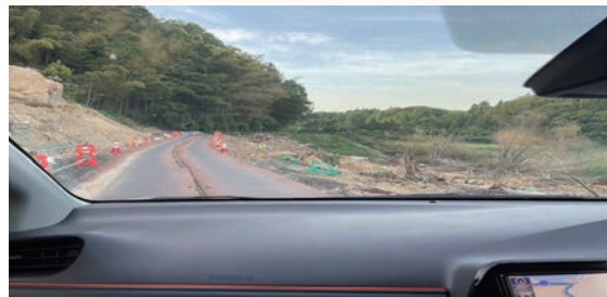
▲土砂崩れ後、鉄板の敷かれた道路
